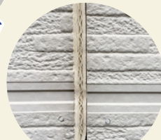
コーキングの劣化
